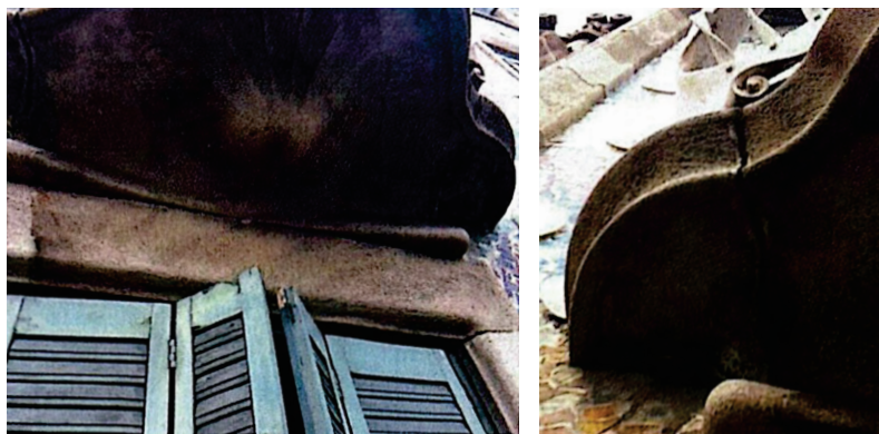
Fig. 121. Villanueva Álvarez et al (2018). Imatges de l'estat de les llosanes dels balcons. Extreta del Projecte de Treballs de Conservació de la façana principal. (Exp N 02-2018LL61564). Localitzat a l'Arxiu Municipal del Districte de l'Eixample
