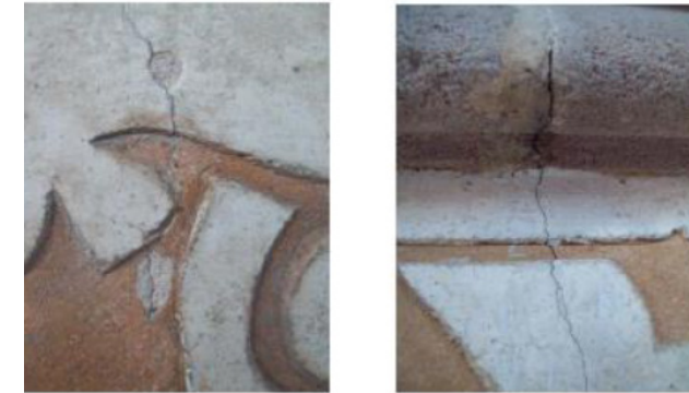
Fig. 92. Fissures zones esgrafiats. Font: Lévano, B (2010).
