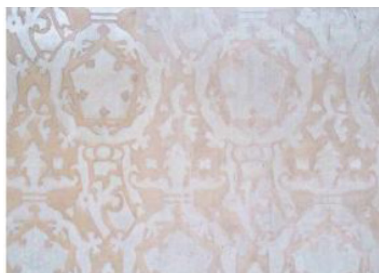
Fig. 53. Detall de l'estat de conservació de l'estuc original a una zona no protegida. Font: Lévano, B (2010).
