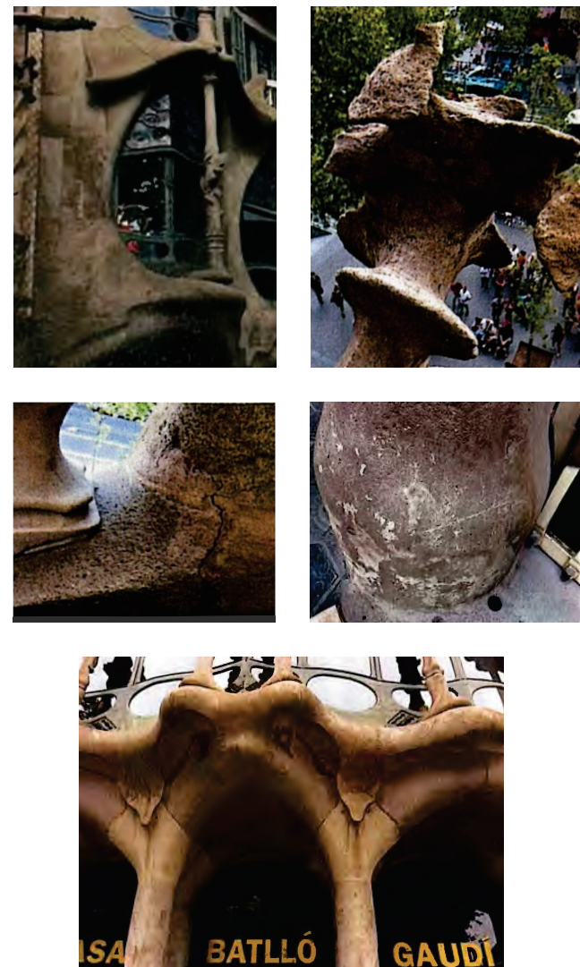
Fig. 123. Villanueva Álvarez et al (2018). Imatges de l'estat de la pedra sorrenca de Montjuïc. Extreta del Projecte de Treballs de Conservació de la façana principal. (Exp N 02-2018LL61564). Localitzat a l'Arxiu Municipal del Districte de l'Eixample
