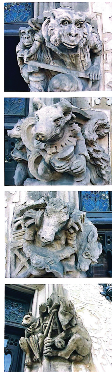
Fig. 62. Tarragó, S. (2006). Imatge de l'estat de les escultures. Extrreta del Projecte bàsic i d'execució de la restauració de la façana de la Casa Amatller. (Exp N 02-2006L18633). Localitzat a l'Arxiu Municipal del Districte de l'Eixample
