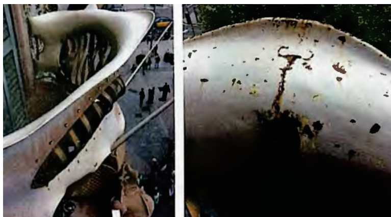
Fig. 122. Villanueva Álvarez et al (2018). Imatges de l'estat dels balcons i baranes metàl·liques. Extreta del Projecte de Treballs de Conservació de la façana principal. (Exp N 02-2018LL61564). Localitzat a l'Arxiu Municipal del Districte de l'Eixample
