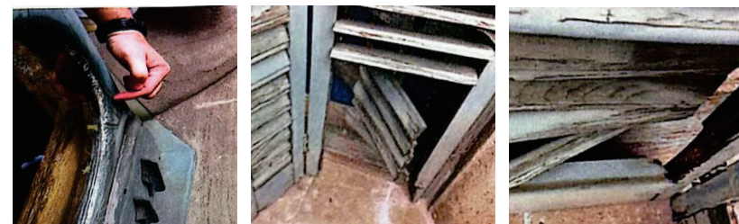
Fig. 125. Villanueva Álvarez et al (2018). Imatges de l'estat de la fusteria. Extreta del Projecte de Treballs de Conservació de la façana principal. (Exp N 02-2018LL61564). Localitzat a l'Arxiu Municipal del Districte de l'Eixample
